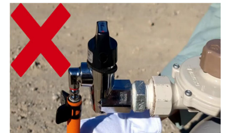
赤い線が見えているため、差し込み不足
